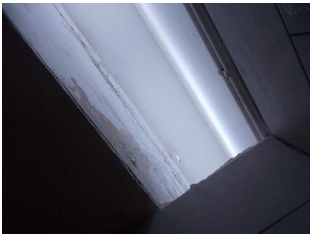
Φωτογραφία 2. Έντονες υγρασίες στην πλάκα οροφής
